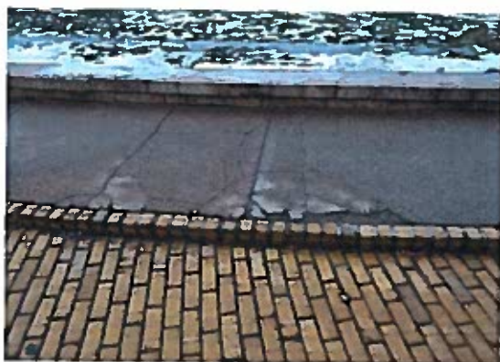
Foto 14. Dale trotuar cu fisuri multiple
