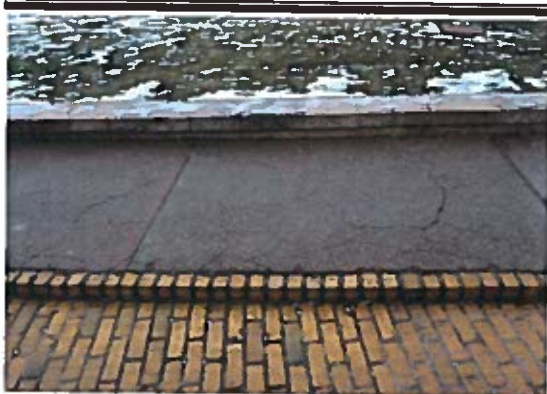
Foto 13. Dale trotuar cu fisuri multiple
