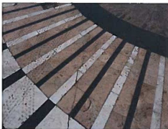
Foto 6. Elemente de pavaj fisurate
